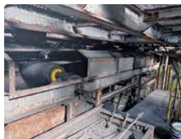
飛灰棟養生コンベア破損部
