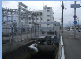
日清紡北ポンプ場
